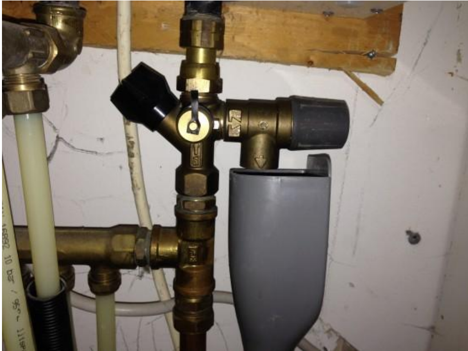
Alternativ sikkerhedsaggregat ved varmtvandsbeholder.
